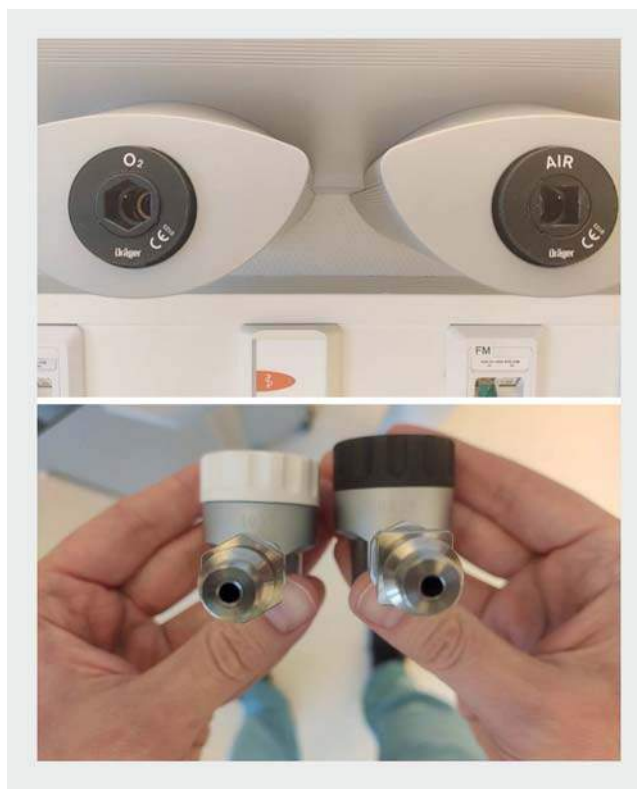
► Abb. 3 Anschlüsse und Steckverbindungen für Sauerstoff (sechseckig) und Druckluft (viereckig). https://www.awmf.org/leitlinien/detail/II/020-021.html [rerif]
